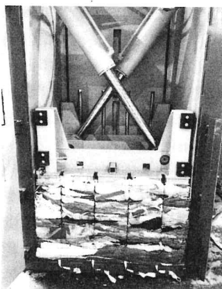
廃プラ等を圧縮結束した装置内
